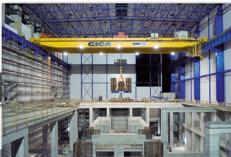
Двухбалочный мостовой кран GDMJ с грузоподъёмностью 120т/50т и пролётом 41,25м в электростанции Ledvice
