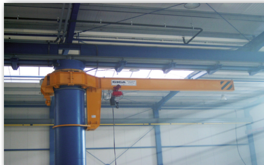
Колонный кран GSOJ 2t/6m на колонне цеха
