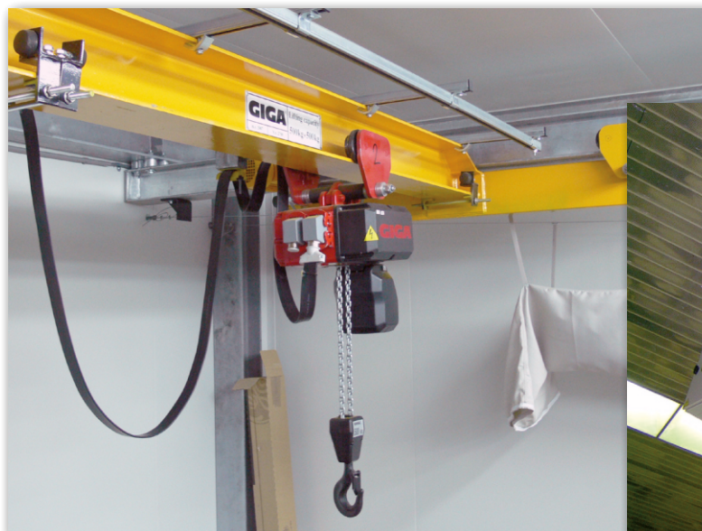
Электрический цепной тельфер CH1 500.4-J, установленный на подвесном мостовом кране GIGA тип GPMJ 2x 0,5t-4,2m. Заказчик - Benteler, s.r.o., Либерец, место установки - Австрия
