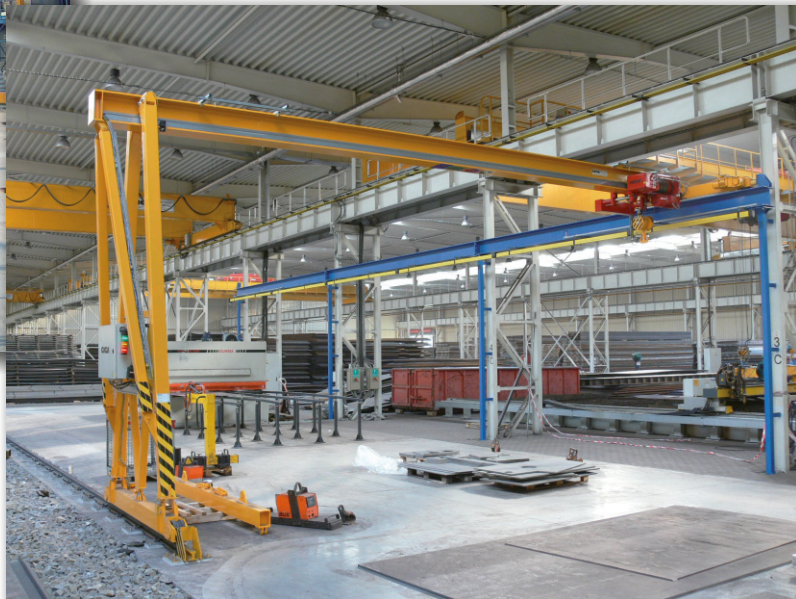
Полукозловой кран GIGA тип GPMJ 5t/9,5m Заказчик - UnionOcel, s.r.o, Прага, Место установки - производственный завод Копршивнице
