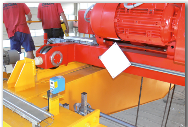
Мостový jeřáb GDMJ 12,5t/27,9m, vybavený pozíciovním kladkostrojem Místo instalace: Presbeton, s.r.o., Olomouc
